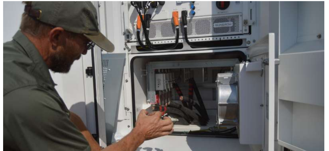
Mauritz verduidelik dat hul oor die algemeen met 70mm kables werk en hier is nou 240mm kables om te koppel
